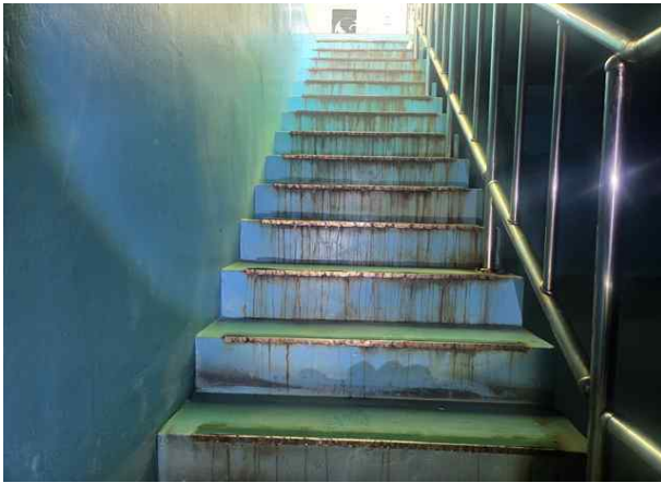
손상내용 1지 계단 녹물 손상원인 공용열화
