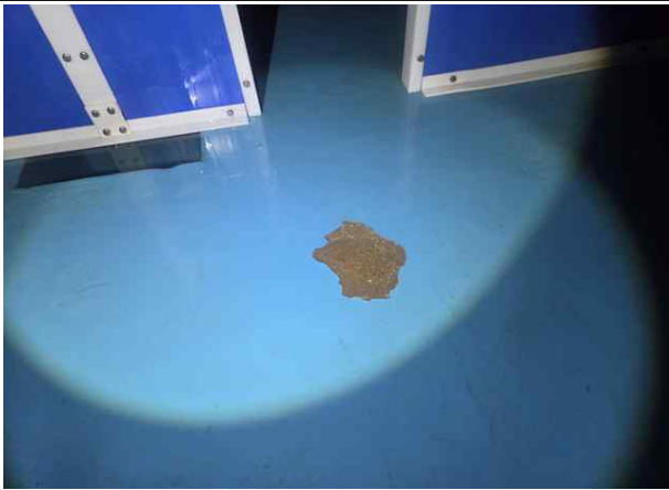
손상내용 1지 바닥슬래브 도장박리 손상원인 공용열화
