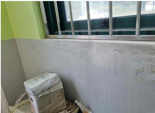
손상내용 전기실 벽체 망상균열 손상원인 건조수축
