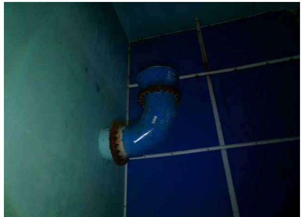
손상내용 2지 유입배관 부식 손상원인 공용열화
