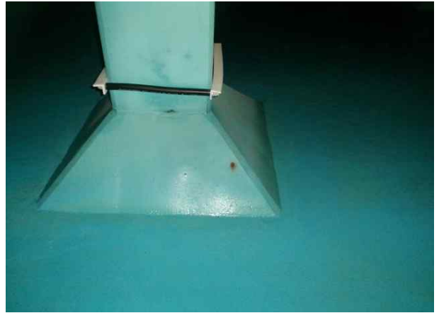
손상내용 1지 기둥 녹물 손상원인 피복부족
