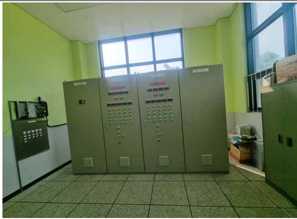
전기실 내부 전경
