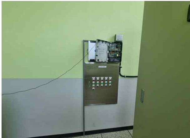
손상내용 현장제어반 상태양호 손상원인 -
