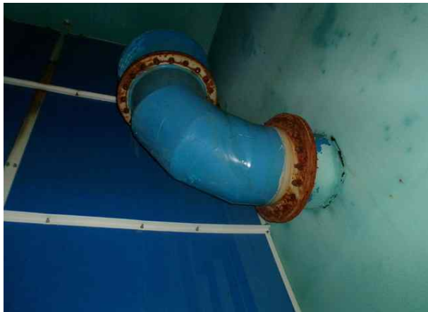
손상내용 1지 유입배관 부식 손상원인 공용열화
