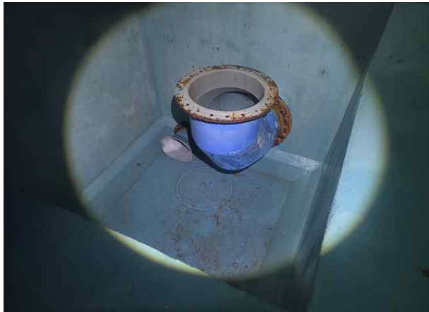
손상내용 1지 유출배관 부식 손상원인 공용열화
