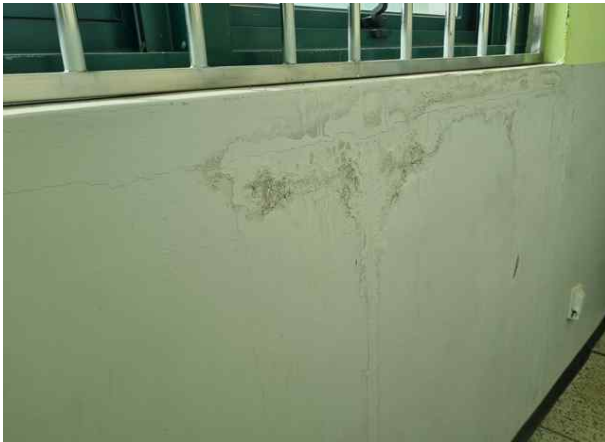
손상내용 전기실 벽체 균열 손상원인 건조수축
