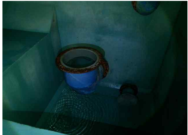
손상내용 2지 유출배관 부식 손상원인 공용열화
