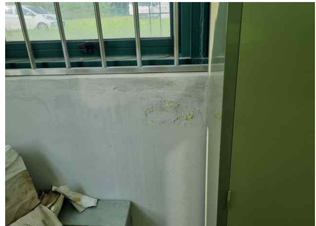
손상내용 전기실 벽체 도장박리 손상원인 공용열화
