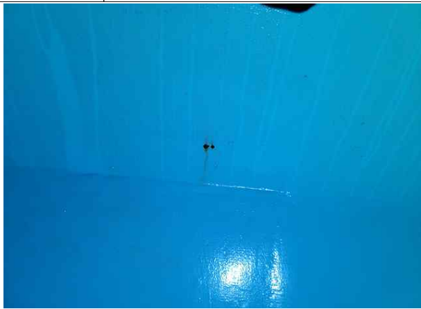
손상내용 2지 벽체 녹물 손상원인 피복부족
