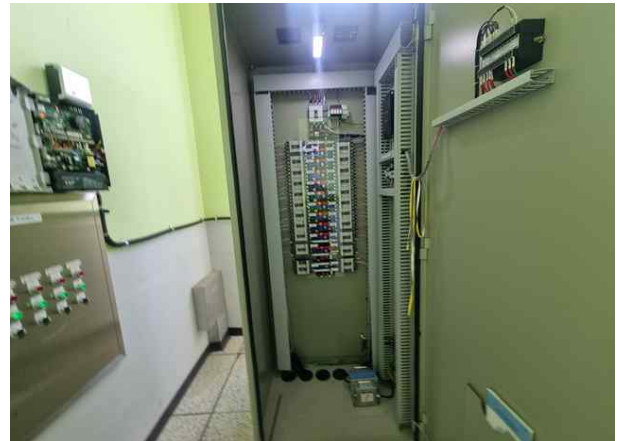
손상내용 현장제어반 상태양호 손상원인 -
