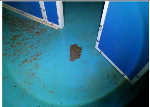
손상내용 2지 바닥슬래브 도장박리 손상원인 피복부족
