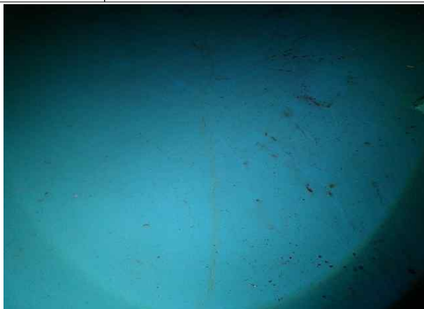
손상내용 2지 바닥슬래브 균열 손상원인 건조수축
