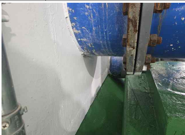
손상내용 유입밸브실 배관볼트 부식 손상원인 공용열화
