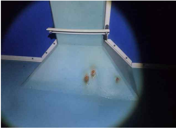
손상내용 1지 기둥 녹물 손상원인 피복부족
