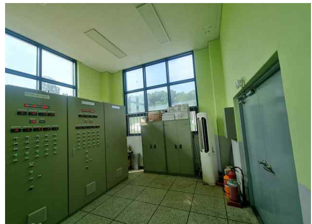
손상내용 현장제어반 상태양호 손상원인 -
