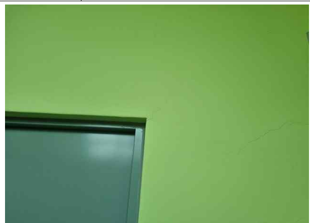
손상내용 전기실 벽체 망상균열 손상원인 건조수축
