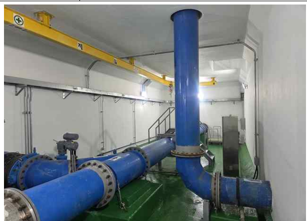
손상내용 유출밸브실 배관볼트 부식 손상원인 공용열화
