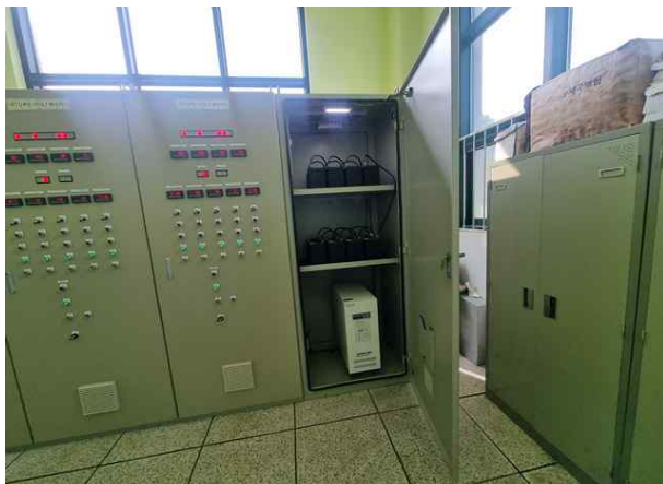
손상내용 현장제어반 상태양호 손상원인 -
