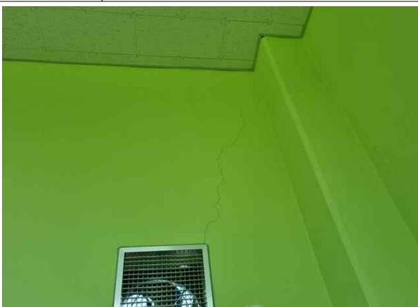
손상내용 전기실 벽체 망상균열 손상원인 건조수축
